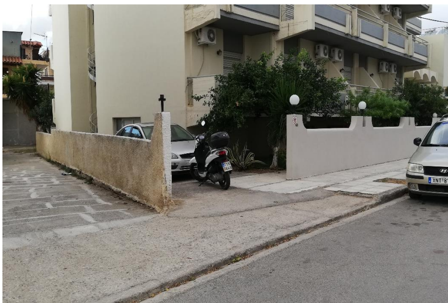
Φ1- 3. Πεζοδρόμιο από τσιμέντο σε κακή κατάσταση με διαφορετική στάθμη.
