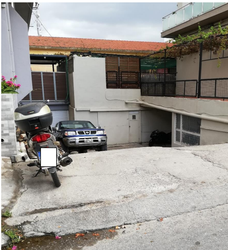
Φ1- 2 Πεζοδρόμιο από τσιμέντο σε κακή κατάσταση – Είσοδος σε ιδιωτικό γκαράζ.
