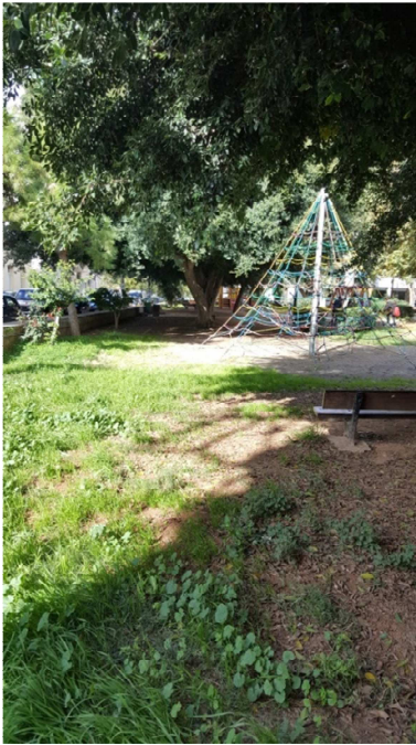
Φ13 Τμήμα παιδικής χαράς με δάπεδο από άμμο και χωρίς σύνδεση με σκληρό υλικό
