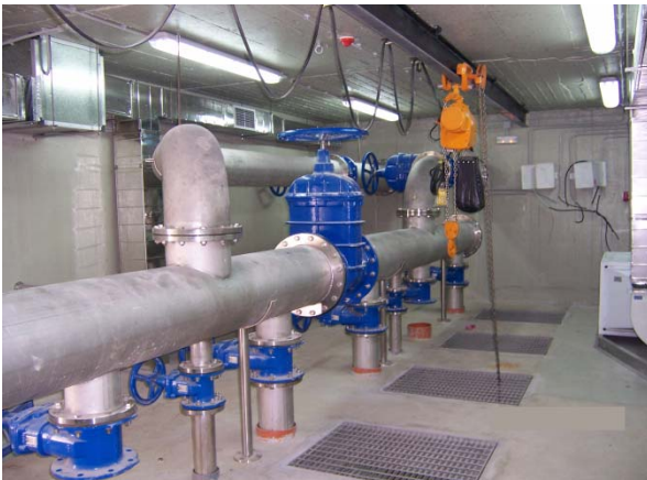
Εσωτερικό αντλιοστασίου λυμάτων στον Καλαθά Ακρωτηρίου
