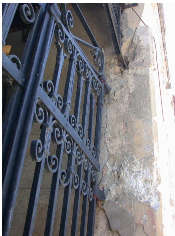
Εικ. 20: Οι οξειδώσεις των στηριγμάτων της θύρας έχουν διαρρήξει τους λίθους.
