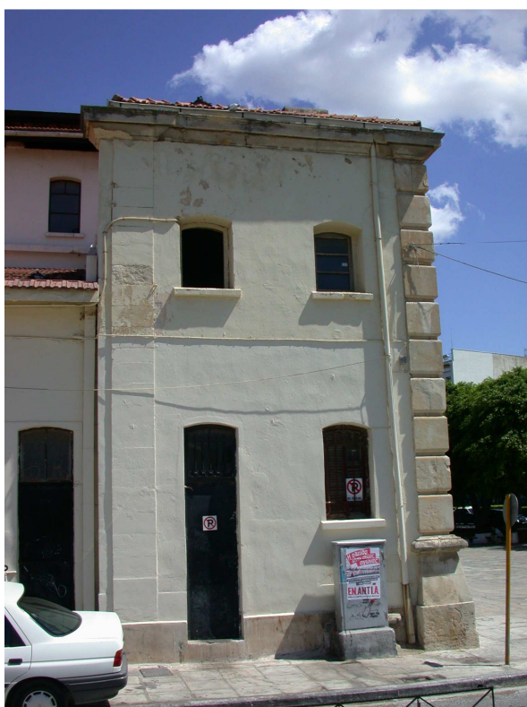
Εικ. 17: Φθορές στην τοιχοποιία λόγω βλαβών στο σύστημα συλλογής και παροχέτευσης των ομβρίων.
