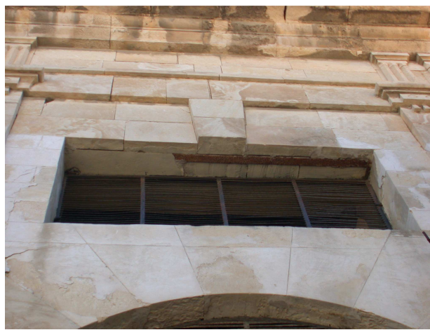
Εικ. 39. Γενική εικόνα των βλαβών στη βόρεια όψη του κτηρίου.
