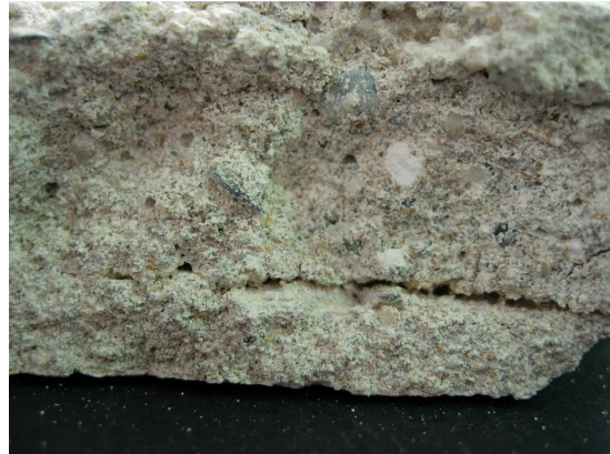
Εικόνα 4. Μακροσκοπική φωτογράφιση, πλάγια όψη. Αποκόλληση στρωμάτων επιχρίσματος. Διακρίνονται χονδρόκοκκα αδρανή και συσσωματώματα υδρασβέστου.
