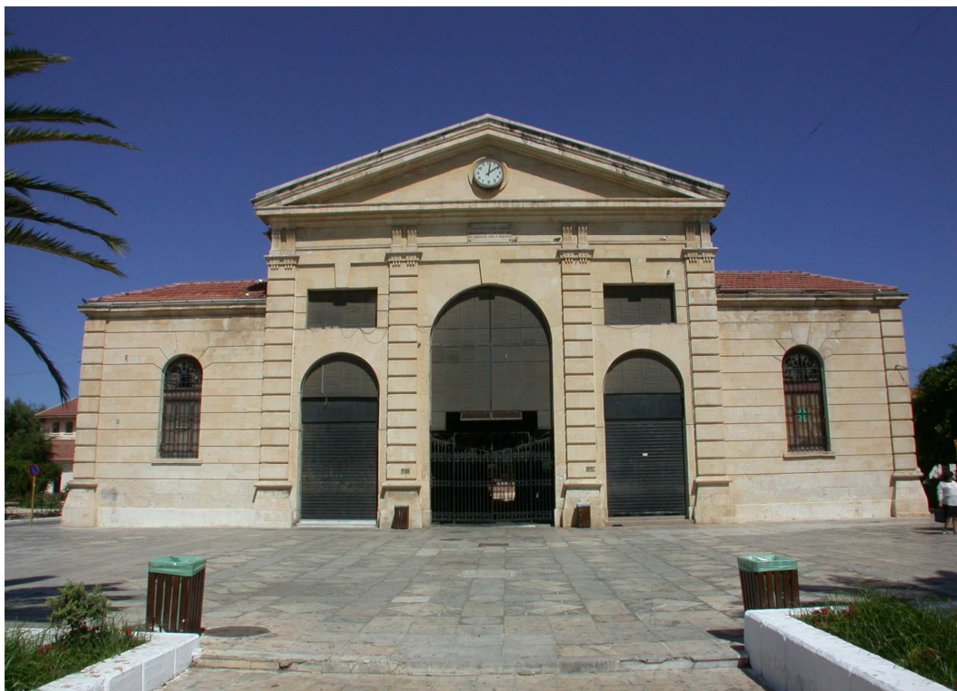
Εικ. 1: Η νότια πρόσοψη του κτηρίου κατασκευασμένη εξ ολοκλήρου από εμφανή λιθοδομή. Παρατηρούνται φθορές στα κατώτερα και ανώτερα τμήματά της λόγω ανερχόμενης και κατεισδύουσας υγρασίας αντίστοιχα.
