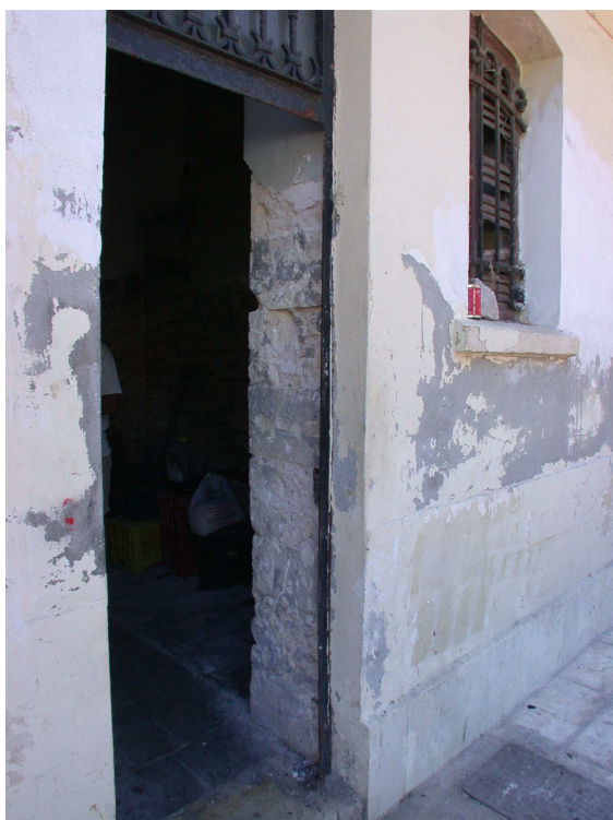
Εικ. 23: Βλάβες στα επίχρυσμα της περιμετρικής τοιχοποιίας.
