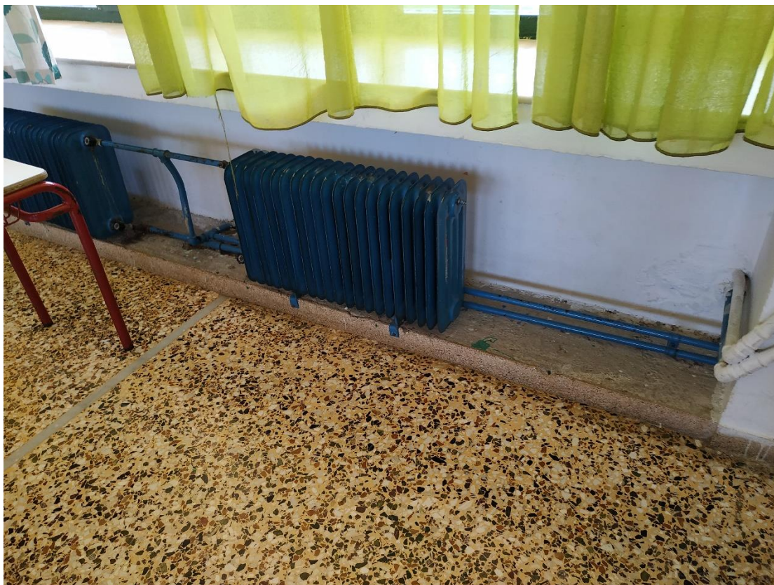
Εικόνα 5. Υπάρχοντα θερμαντικά σώματα κτιρίου.
