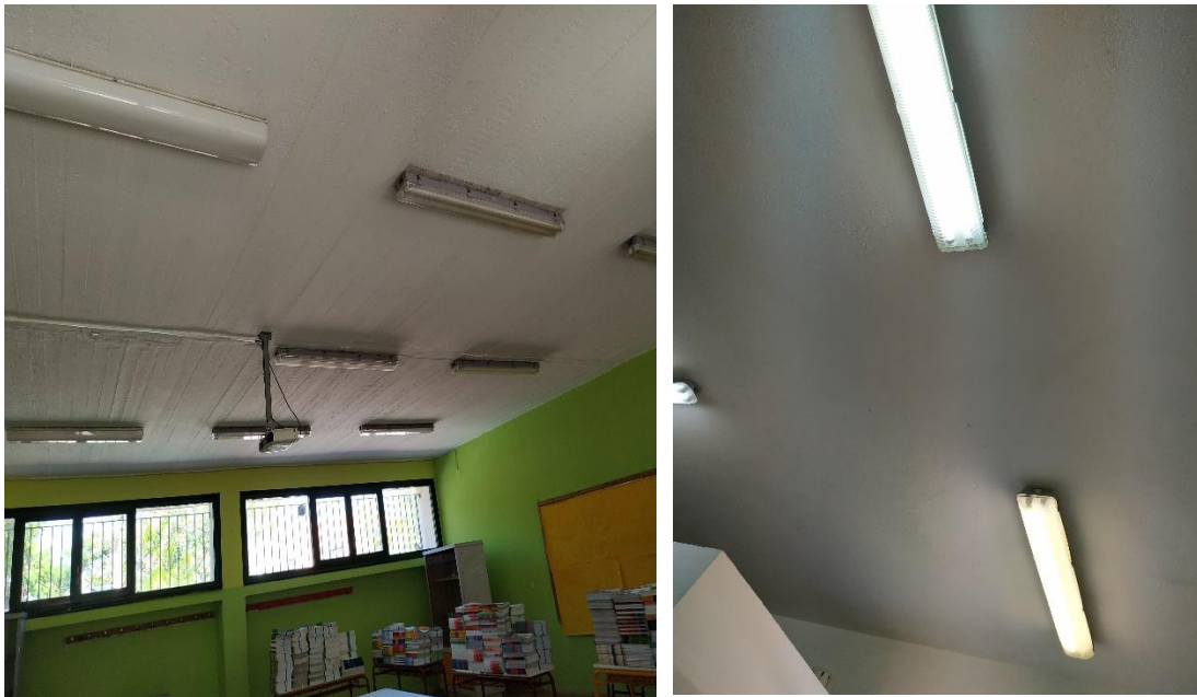
Εικόνα 6. Υπάρχον φωτιστικό σύστημα.
